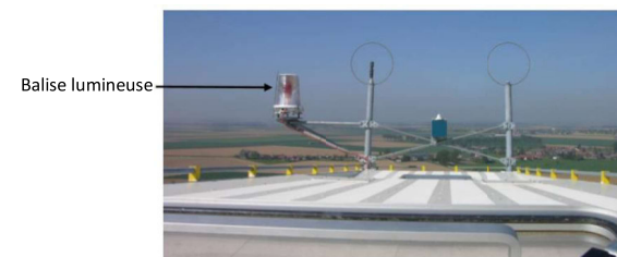
Figure 24: Système de balisage lumineux (Source : ECOTERA)
